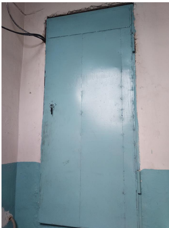
Рисунок 4 – Вход в машинное помещение
