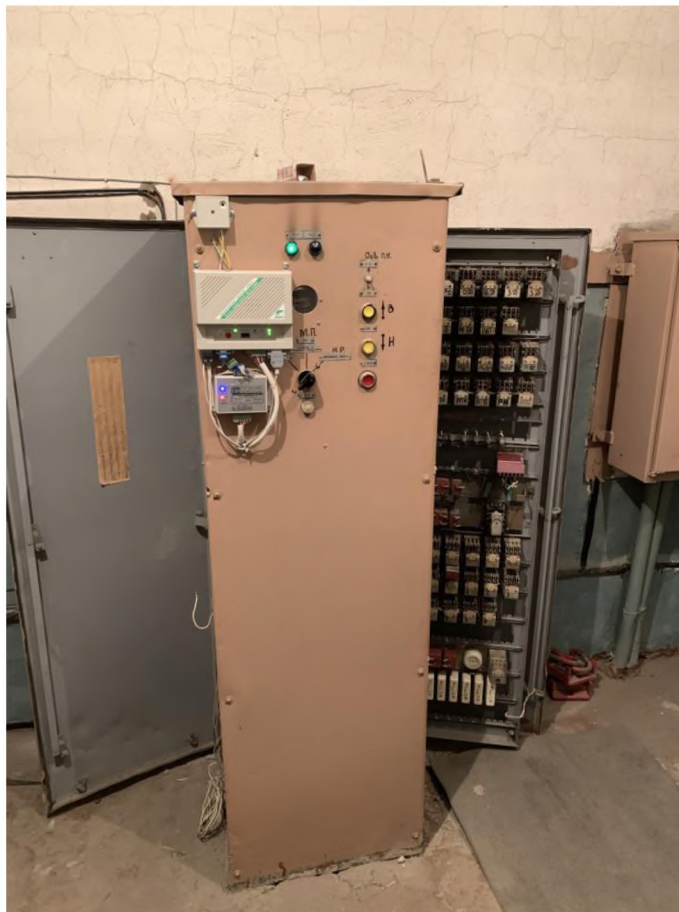
Рисунок 5– Шкаф управления и лебедка
