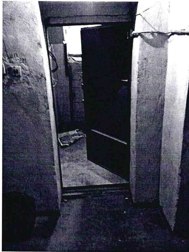
Рисунок 4 – Вход в машинное помещение
